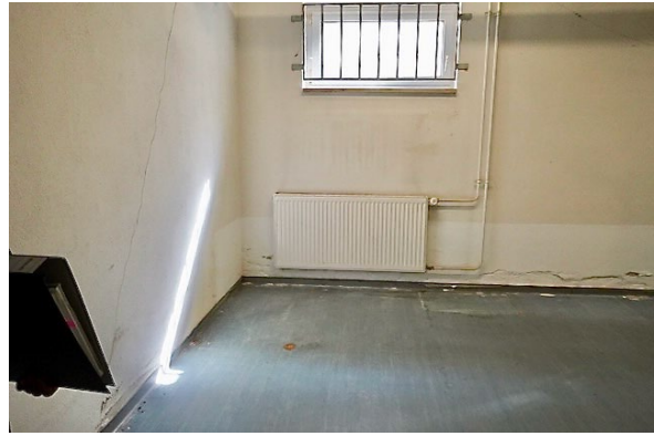
Kellerbereich mit Feuchtigkeitsschäden
