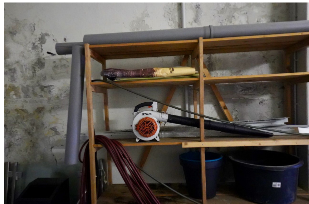
Durchfeuchtung der Außenwand (Großgarage)
